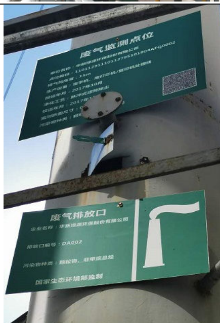
打/复印 机、手 机等拆 解线 A002
